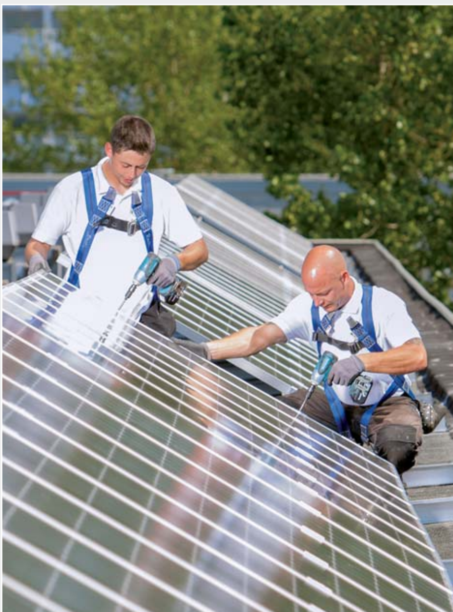
1.600 Module hat die WIRO 2012 auf Dächern von Fünfgeschossern in Evershagen, Lichtenhagen und Groß Klein aufgebaut. Mit allen 42 Anlagen sinkt der Kohlendioxidausstoß jedes Jahr um fast 1.000 Tonnen.
